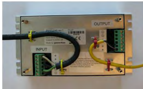
รูปที่ 15: สายไฟที่เชื่อมต่อกับแหล่งจ่ายไฟ
