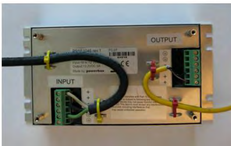
Рисунок 18: Кабели, присоединенные к блоку питания
