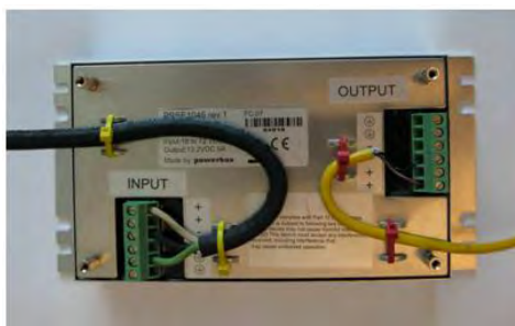
Рисунок 41: Кабели, присоединенные к блоку питания
