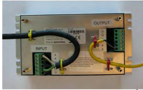
Rajah 16: Kabel Disambungkan ke Bekalan Kuasa
