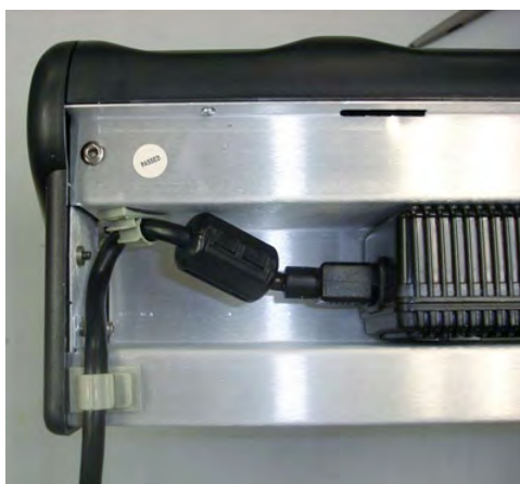
Attēls 72: Kabelis izvadīts caur plastmasas saspraudēm
