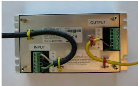
図 15 : 電源に接続されたケーブル
