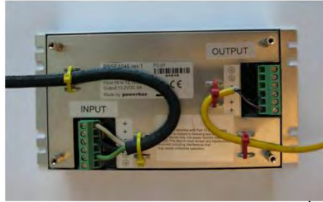
図 15 : 電源に接続されたケーブル
