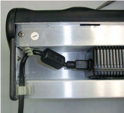
図 24 : プラスチック クリップを通し誘導されたケーブル
