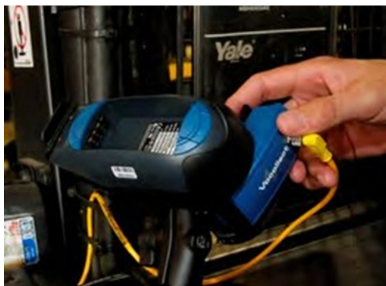
איור 46: מתאם סוללה מעוגן במכלול VMT
