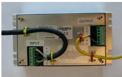
Illustration 15: Câbles branchés à l'alimentation électrique
