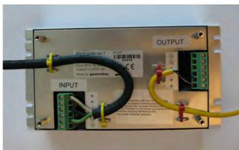
Illustration 27: Câbles branchés à l'alimentation électrique
