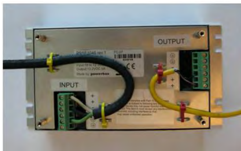
Illustration 56: Câbles branchés à l'alimentation électrique
