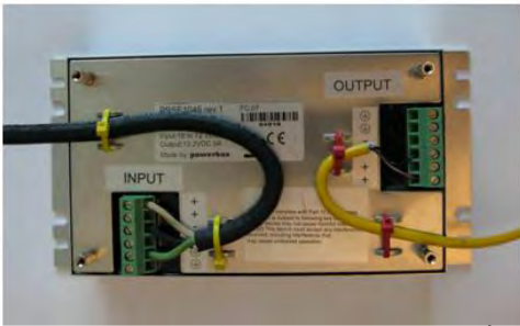
Figura 61: Cables conectados al suministro eléctrico
