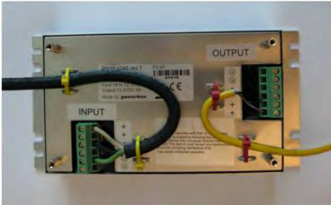
Figura 27: Cables conectados al suministro eléctrico
