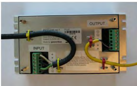
Figura 27: Cables conectados a la fuente de alimentación
