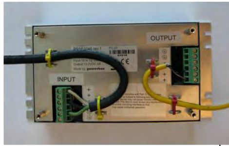
Abbildung 15: An die Stromversorgung angeschlossene Kabel
