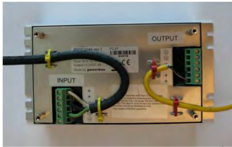
圖 38: 連接電源供應器的纜線
