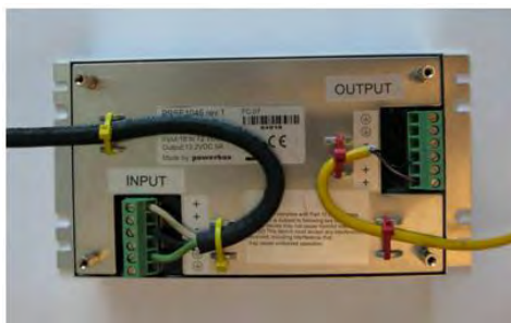
Figura 36: Cabluri atașate la sursa de alimentare
